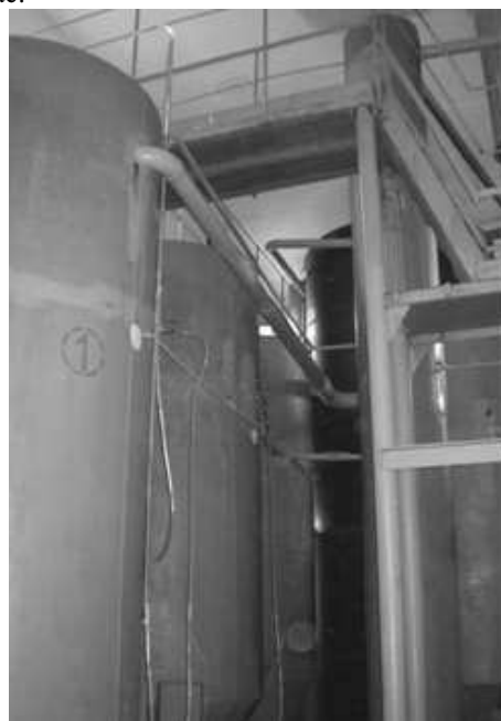
Рис. 6. Пенополистирольные фильтры с технологическими трубопроводами
