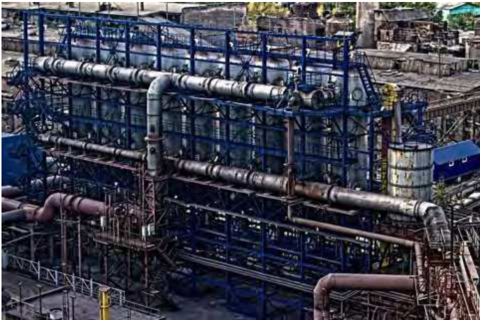
Рис. 3. Общий вид сухой системы очистки доменного газа
