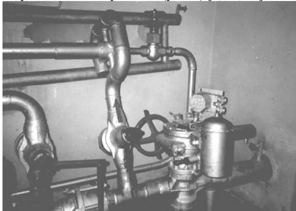
Рис.4. Вихрова труба на діючій газорозподільній станції
