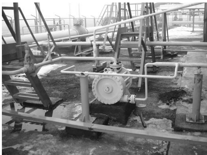
Рис. 3. Установка ДГУ-8-380-Т-У1 на "АГРС-5 Волгоград"
