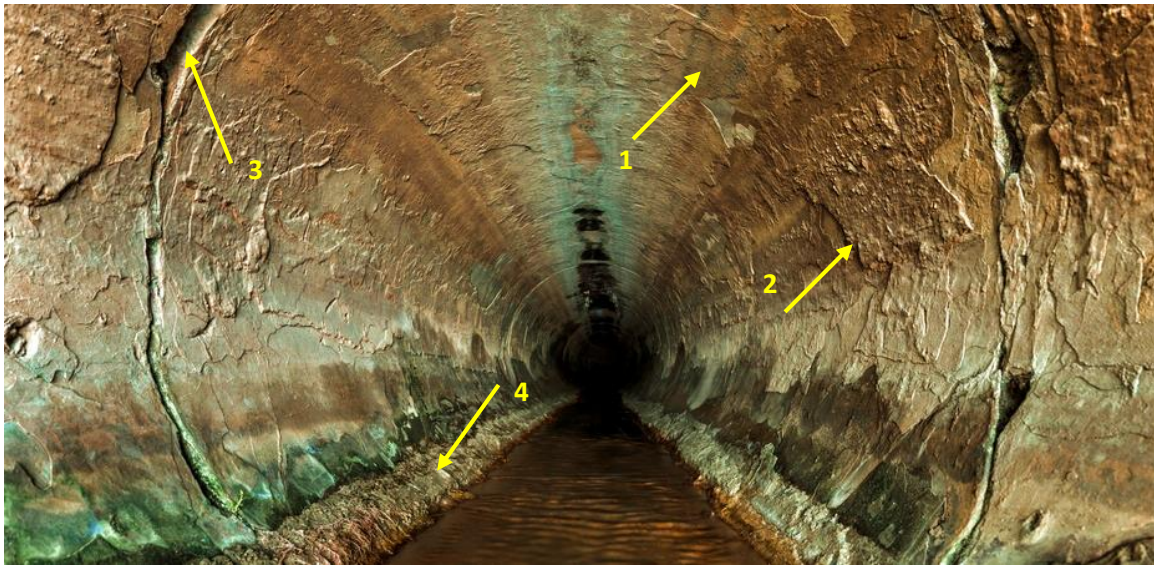
Рис. 1. Характерные повреждения железобетонных трубопроводов
