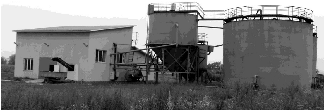
Рис. 2. Очистные сооружения предприятия «Букофрут» Fig. 2. «Bukofrut» wastewater treatment plant
