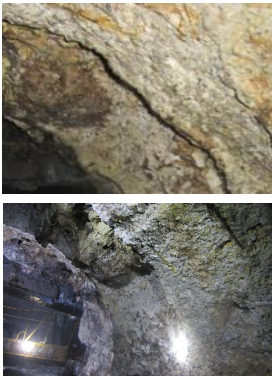
Рис. 2. Внутренняя поверхность канализационных тоннельных коллекторов, разрушенная коррозией
