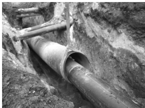
Рис. 12. Монтаж РЕ водопроводной сети в кожух Fig. 12. Installation of PE water supply in housing
