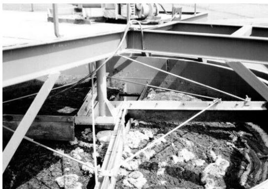
Рис. 5. Флотошлам на поверхности отстойника-флотатора очистных сооружений предприятия «Голд Транс Интернешнл»
