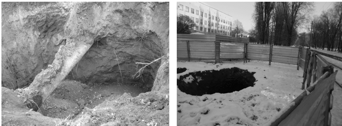
Рис. 3. Первичная стадия проседания грунта в зоне повреждения коллектора
